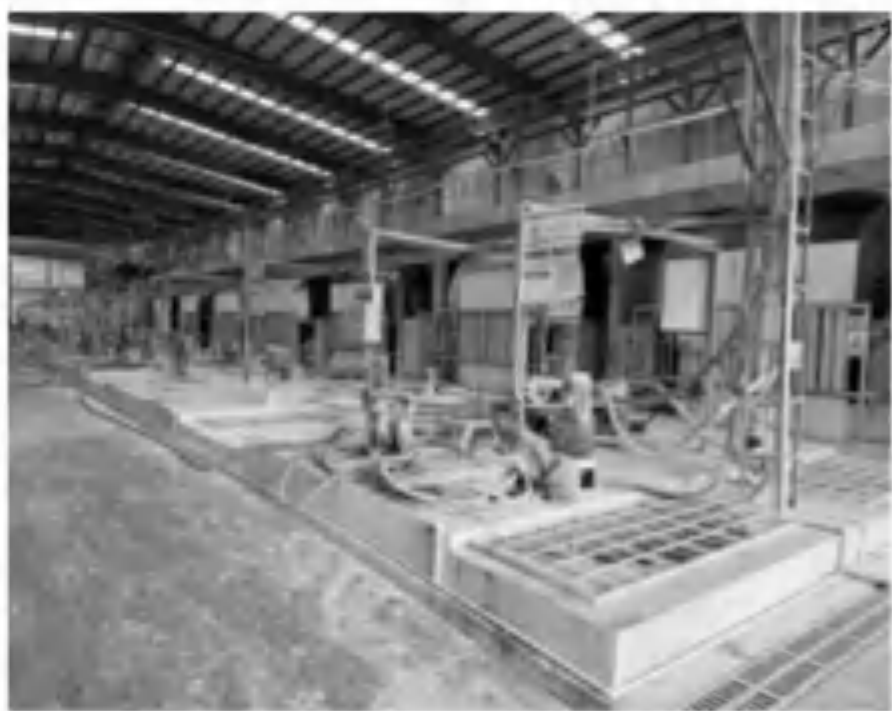
车间二内浆料池（应急时可做事故水暂存设施）
